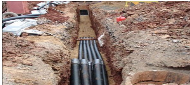
Figura 2.21 - Banco de dutos, rede via subterrânea
